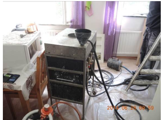
Bild 8. Varmluftsaggregat för inblåsning ca +500°C luft i tättningsstrumpor.
