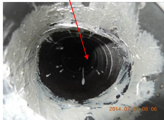
Bild 12. Befintlig frånluftskanal med invändig tättningsstrumpa. Övertemperad övertrycksluft har blåst upp strumpan s
