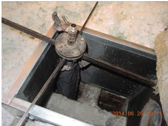
Bild 7. Efter att tättningsstrumpan monterats ska den blåsas upp med het varmluft från varmluftsaggregat.
