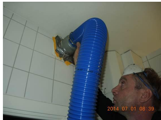
Bild 4. Slang från provstryckningsfläkt provisoriskt ansluten till frånlufts kanal från badrum.
